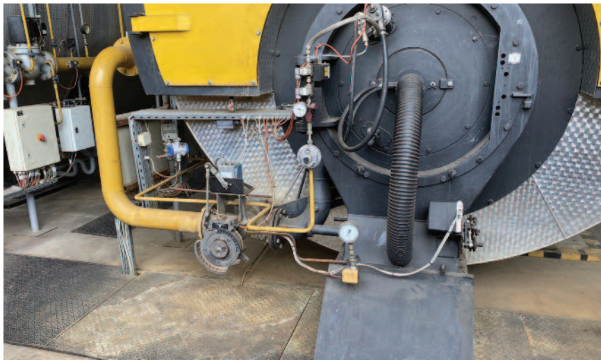
3. kép – Nagy teljesítményű kazán légcsatornás égésilevegő-ellátással
