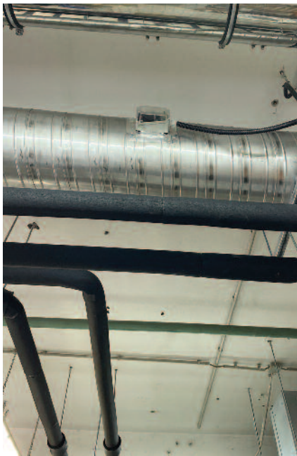
2. kép – Áramlásérzékelő, égcsatornába szerelve
