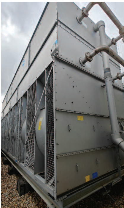
2. kép: A hűtőtorny a tetőre telepítve
