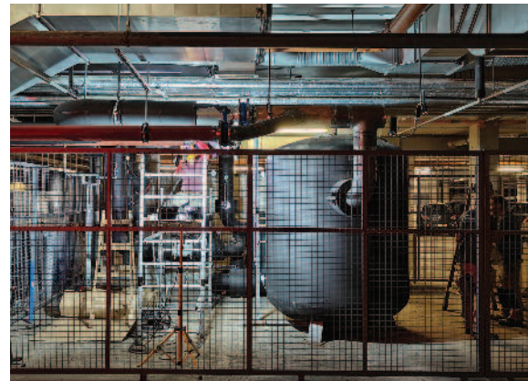
3-4. kép: A hotel hőszivattyús rendszerének kialakítása: gépek a tetőn, elosztórendszer a pincészin
