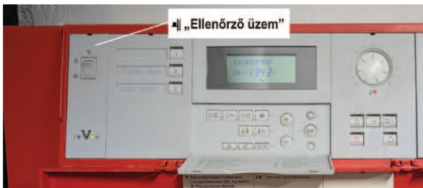
3. kép: Az ellenőrzőüzem beállítása egy korszerű gázkazánon
