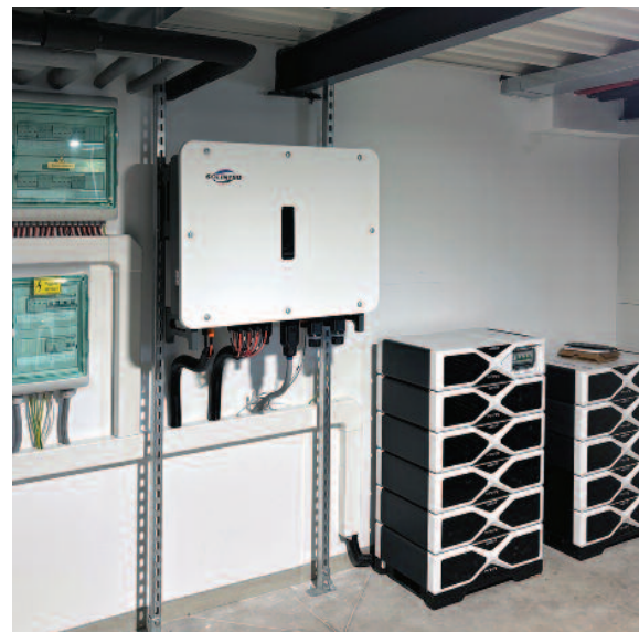
2. kép: 50 kW-os inverter és 52 kWh-s energiatároló egy üzemi épületben telepítve
