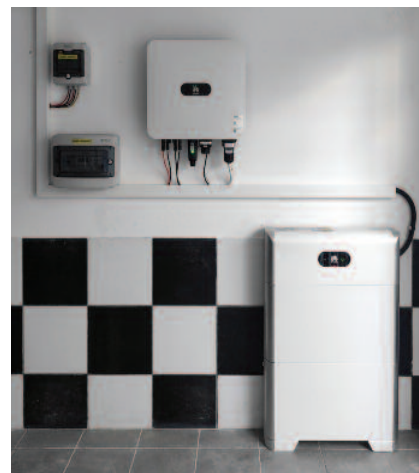
1. kép: 5 kW-os inverter és 10 kWh-s energiatároló beltérben telepítve
