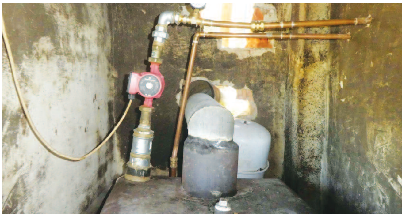
1. kép – A tárgyalt kazán csőcsatlakozásai a beépített keringtetőszivattyúval
